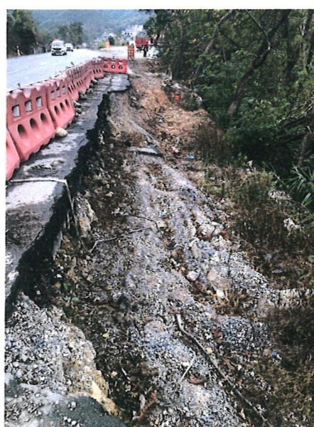
图 4-3 水毁路段右侧边坡坍塌
