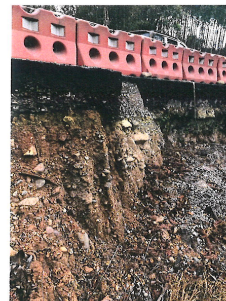
图 4-2 路基坍塌断面
