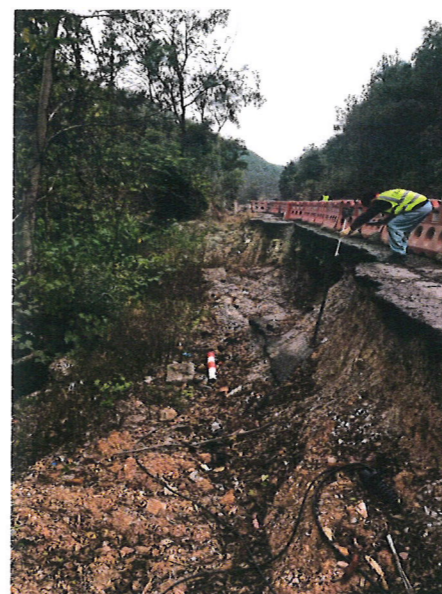
图 4-1 水毁路段右侧边坡坍塌
