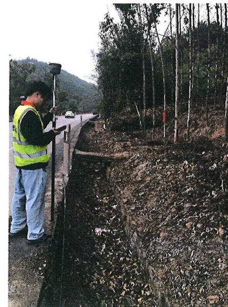
图 4-4 水毁路段左侧水沟
