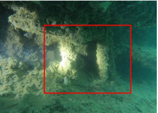
2#墩承台巴马面破损、露筋
