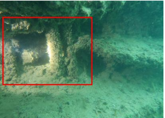
2#墩承台巴马面破损、露筋
