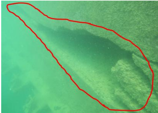
1#墩承台福州面破损
