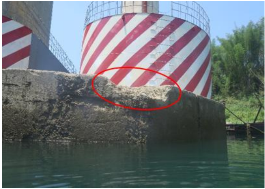
2#墩承台右侧面崩角
