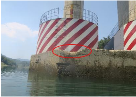
2#墩承台右侧面崩角
