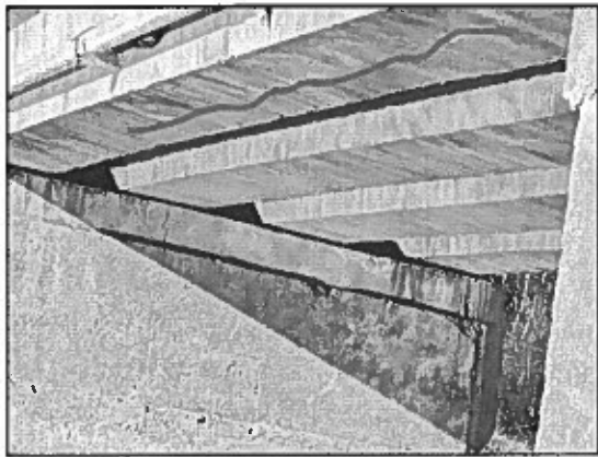
图2 空心板纵向裂缝
