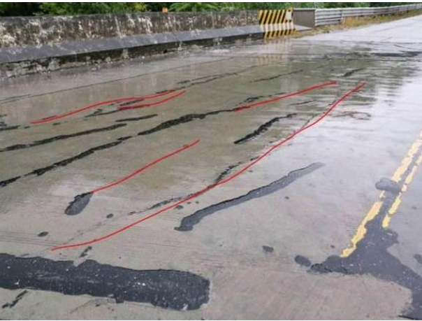
1#桥面铺装纵向裂缝
