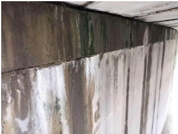
0#台身前墙受水侵蚀
