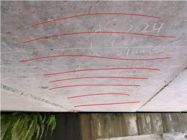
1-10#空心板板底横向裂缝
