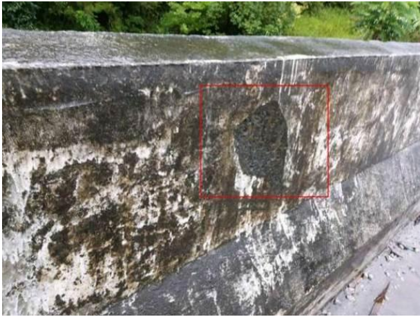
左侧护栏破损
