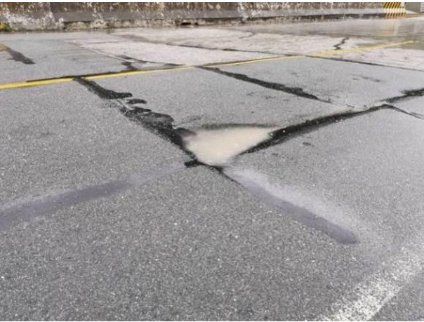
0#台桥面铺装变形
