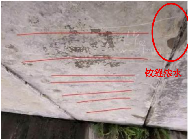
1-5#空心板板底横向裂缝（铰缝渗水）
