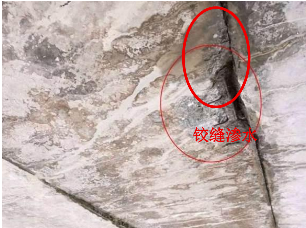
1-7#空心板板底剥落、掉角露筋、铰缝渗水、
