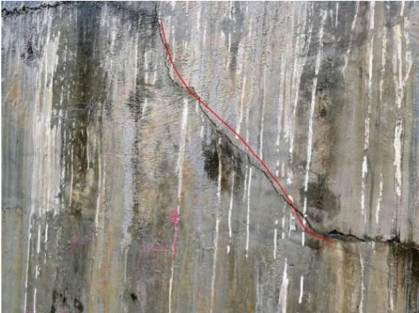
0#台身右侧侧墙斜向裂缝
