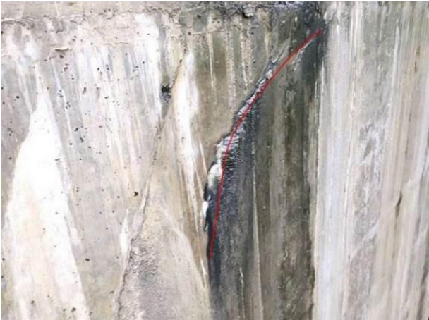
0#台身左侧侧墙斜向裂缝
