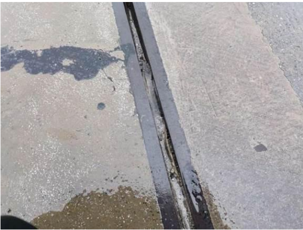
1#伸缩缝止水带破损橡胶止水带老化破损
