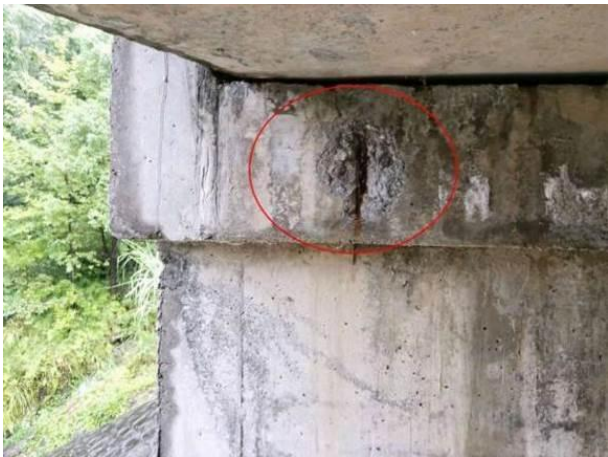
1#台帽前墙(台帽)破损露筋
