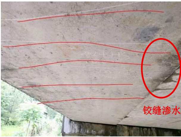
1-1#空心板板底横向裂缝（铰缝渗水）
