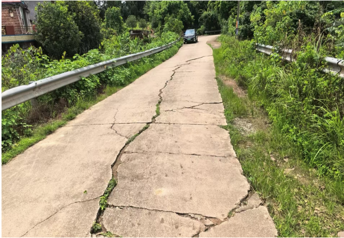
现状道路病害，需处治
