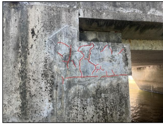
台帽网状裂缝
