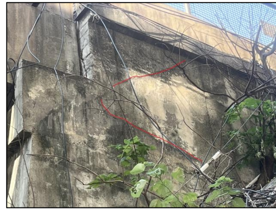
台身斜向裂缝
