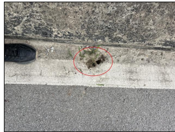
排水系统堵塞
