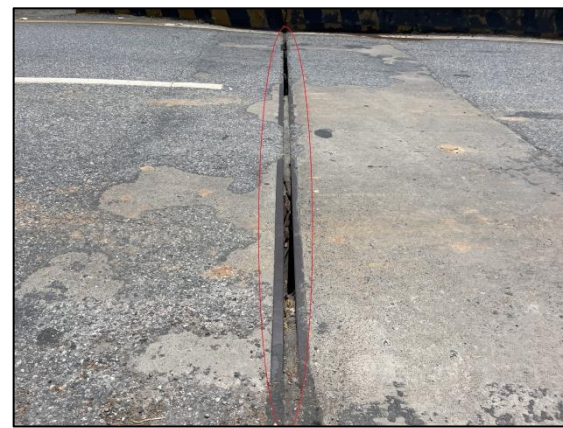
伸缩缝橡胶止水带老化、破损
