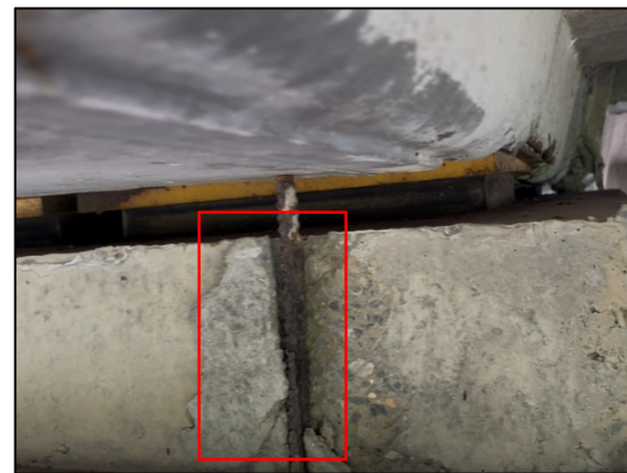
支座底板混凝土破损
