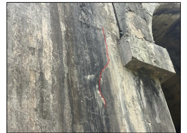
台身竖向裂缝
