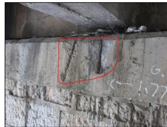
墩帽剥落、露筋且锈蚀
