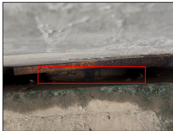
支座橡胶开裂
