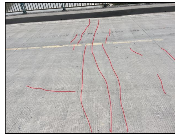
桥面网状裂缝
