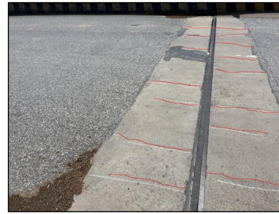
伸缩缝锚固区开裂化
