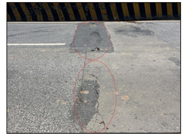
桥面坑槽、坑洞
