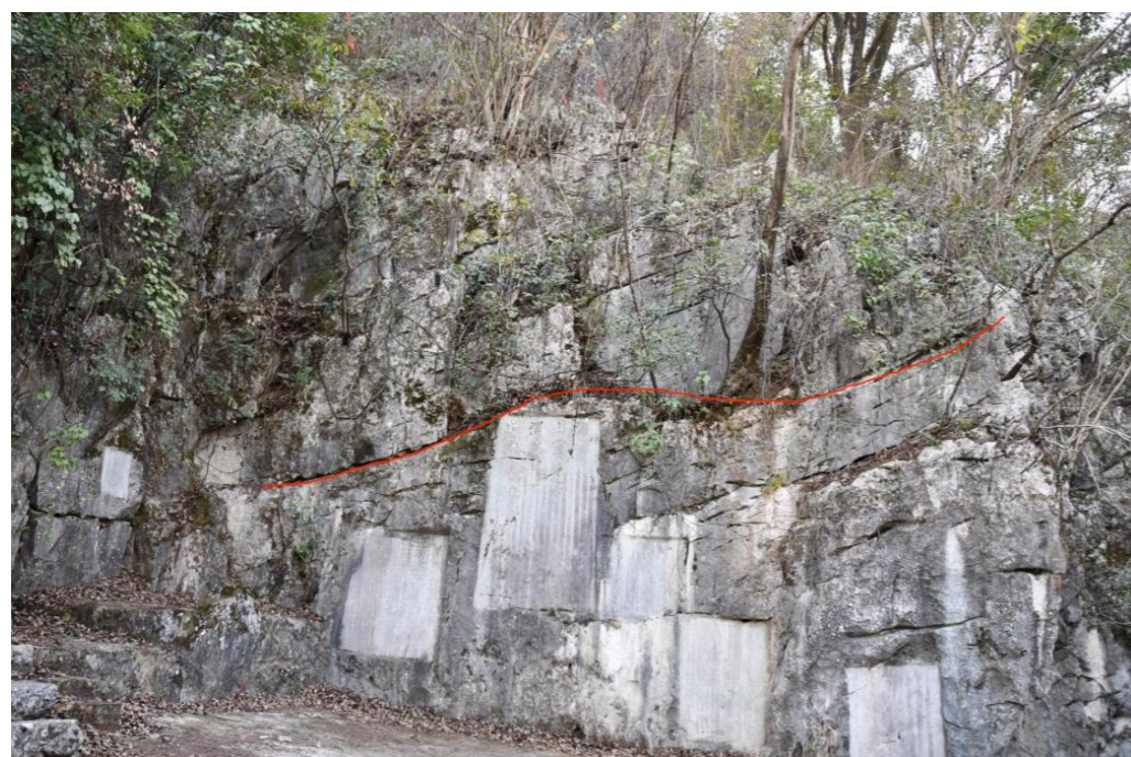
图 4.2-2 崖壁发育层理裂隙
